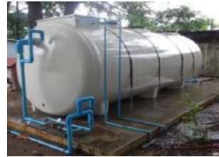
近畿地方153件 (例:滋賀県の浄化槽)
